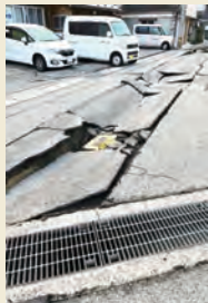
陥没した道路
